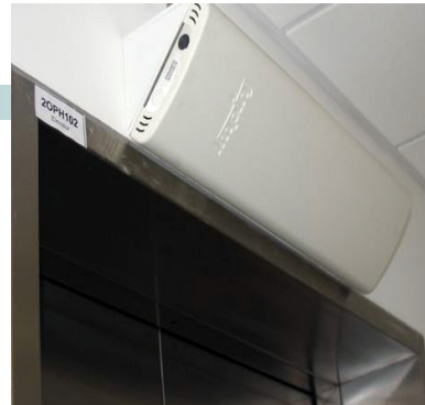
Door Portal Reader
